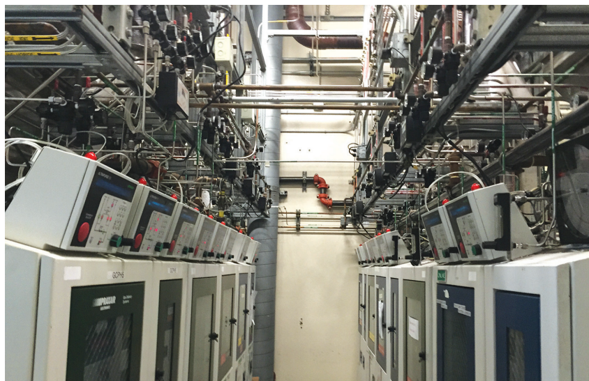
圖 4：密集的金屬和混凝土 – 無線節點即使在位於金屬設備和配氣管之間時也必須可靠地運行
